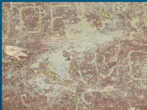
Azaleraren higadura. Erosiones de la superficie.
