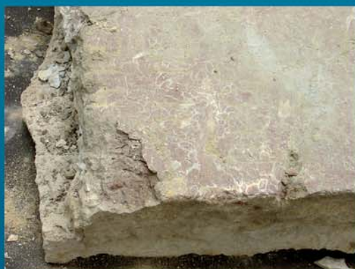
Euskarriaren galera. Pérdida de soporte.
